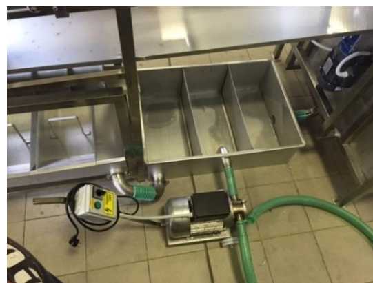
Sump med grovsil og nivåvakt for automatisk start og stopp av pumpe og evt. oppvarming
